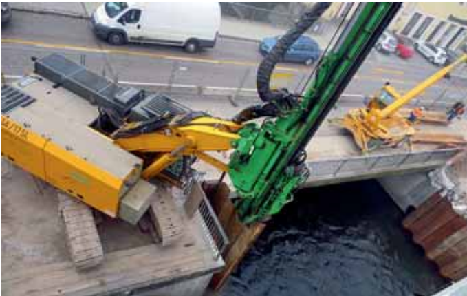
Eine Maschine mit 54 Tonnen Eigengewicht rammt die Spundwände in den Boden. Markt Manching (StH)
